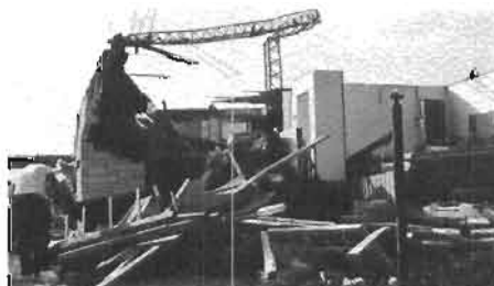
Destruction de la résidence lors d'une tornade, 18 juin 1985
