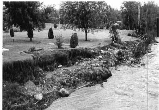
Érosion des berges, rivière aux Pins.
