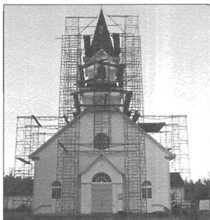
Notre église lors de ses rénovations de la couverture jusqu'au clocher. Certains se rappellent que notre curé M. Baron avait lui-même peinturé la croix du clocher
