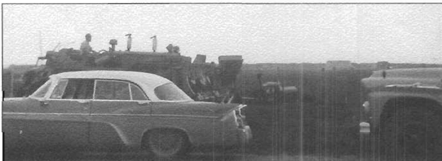
Début de la construction du pont de béton sur la rue Ste-Hélène en 1959
