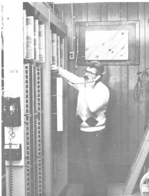
Programmation de l'équipement avant l'installation extérieure.
