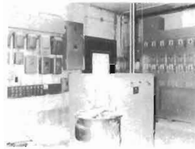
Aujourd'hui : Chambre de contrôle du nouveau concasseur, une force de pouvoir extraordinaire.
