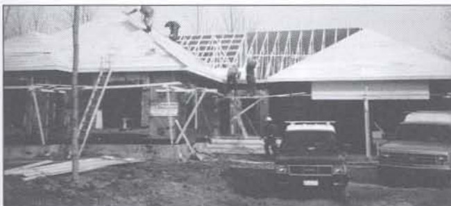
Construction de la maison familiale rue Des Citadins, mars 1990 (oeuvre de la compagnie Les Entreprises L.O. Royal (1985) Inc.)
