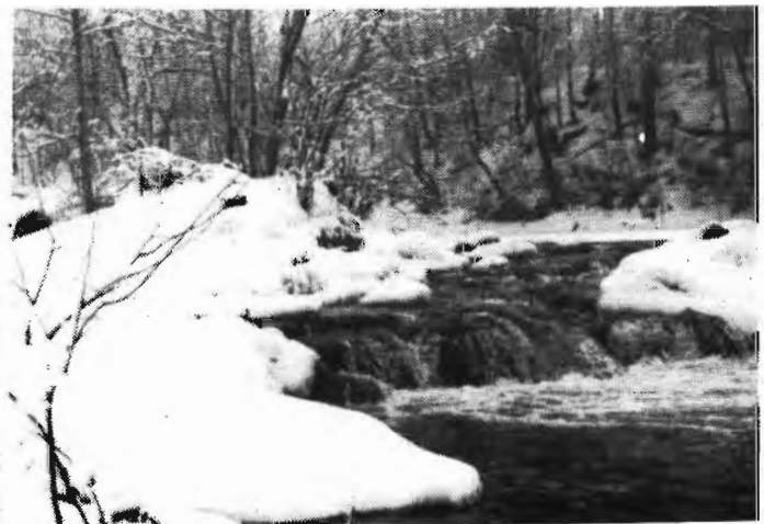
Cette jolie cascade cachait bien son jeu; elle a miné le côté droit du barrage qui ne peut plus maintenant retenir les eaux.
