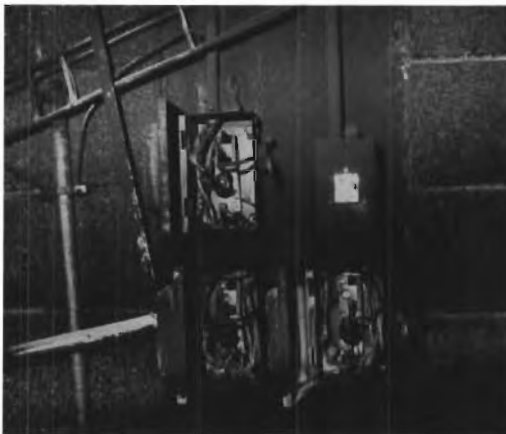
Reliques du feu de 1982, dans la chaufferie.
