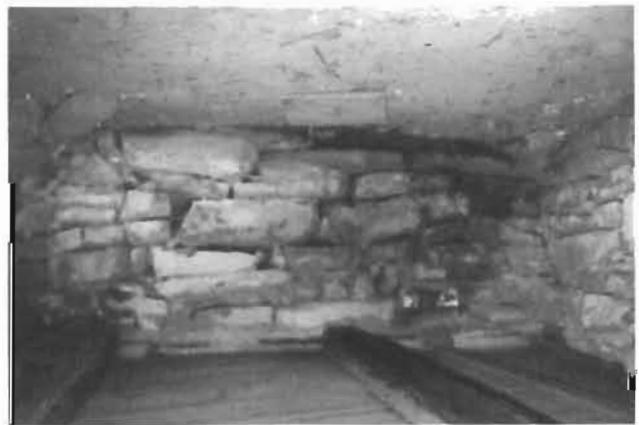
188. Fondations de pierre de la maison McCarthy, côte Saint-Nicholas ouest. D. (A.B.)
