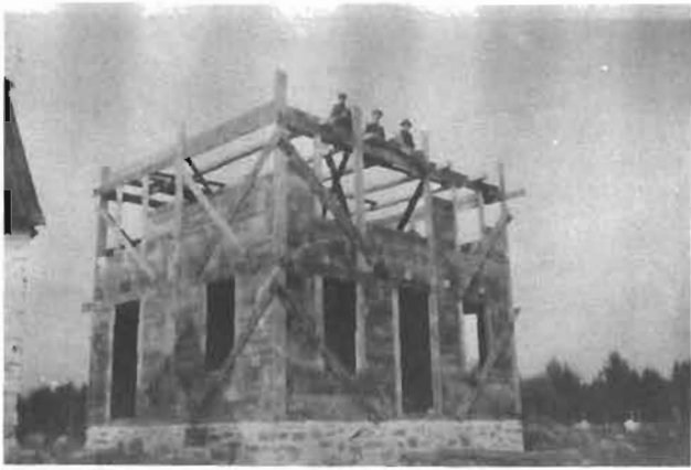
206. Maison de type boom-town. Construction de la maison Blondin en octobre 1923. (C.P.)
