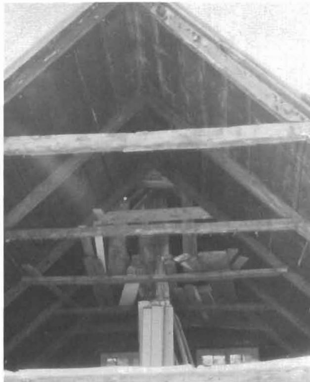
201. Charpente du toit de la maison Beuregard à chevrons et entrails. Ce type d'assemblage très simple révèle des influences architecturales anglo-saxonnes. D. (A.B.)
