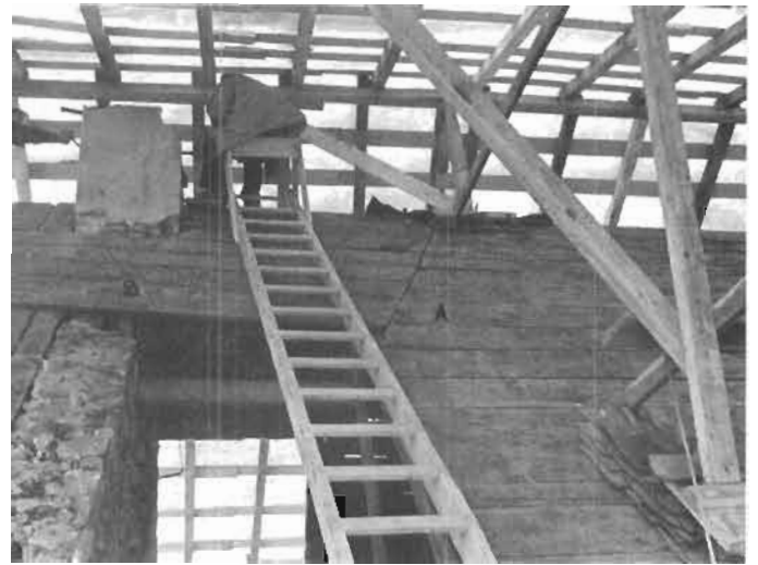
Une étape du curetage du toit. Le pignon de pierre et une partie du toit sont encore en place. On distingue très nettement la séparation entre le toit ancien (A) et la réparation actuelle (B)
