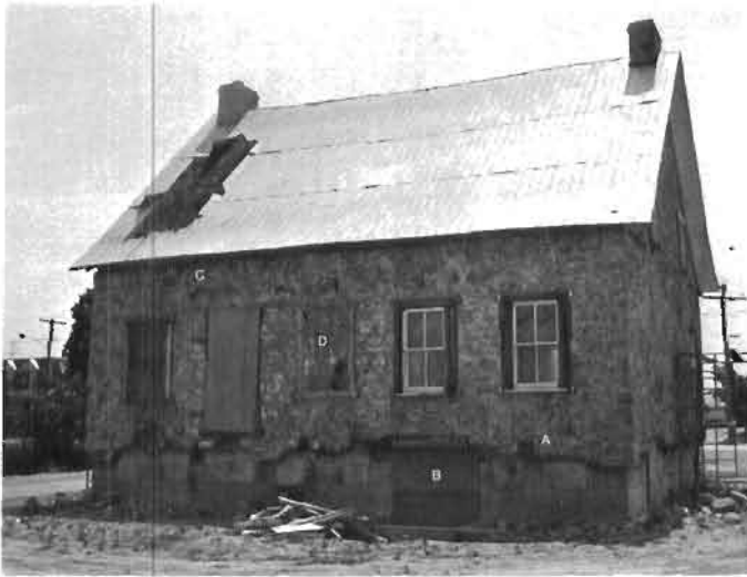
Façade arrière de la maison lors du curetage. On peut apercevoir l'ancien bardeau sous la tôle de la couverture.
