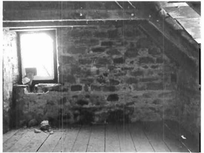
La chambre occupait anciennement ce coin du grenier. La photographie présente une vue intéressante du pignon La dissemblance de la maçonnerie à la hauteur de la sablière est nettement visible Le plancher n'a subi aucune modification.
