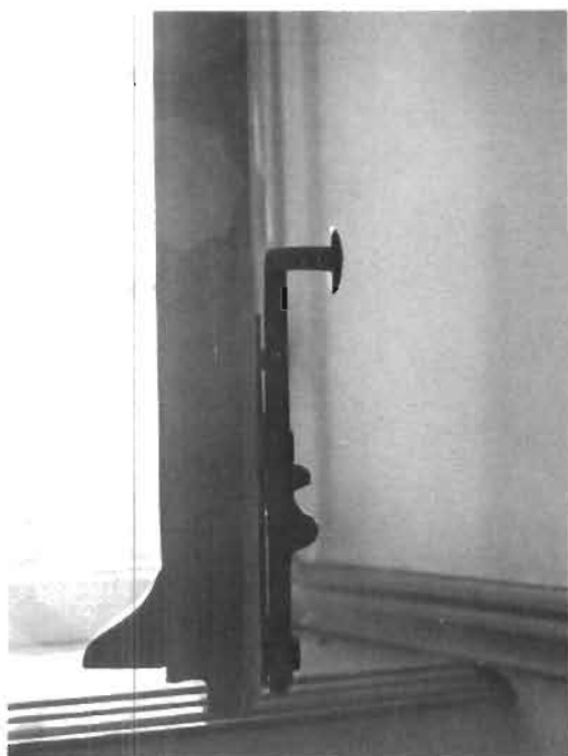
Détail de la targette des fenêtres Profil de l'allège et de la cymaise d'origine.
