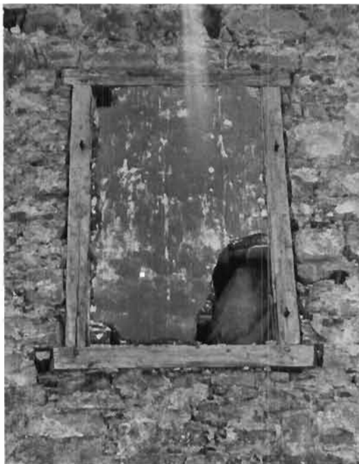
Fenêtre condamnée découverte dans le mur arrière Cadre fait en cèdre avec joints à tenon et mortaise reliés par une cheville. Le prolongement des deux pièces horizontales au-delà des jambages servait d'ancrage pour le cadre.
