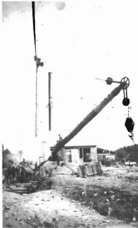
Le palan qui servait à monter les blocs de marbre à la surface de la terre.
