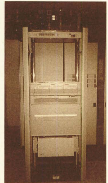
Terminal de fibre optique de Sogetel à Beauceville
