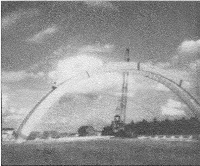
Jérôme Larochelle aux commandes de sa grue vient tout juste de hisser la deuxième arche et, à gauche, un ouvrier la fixe.
