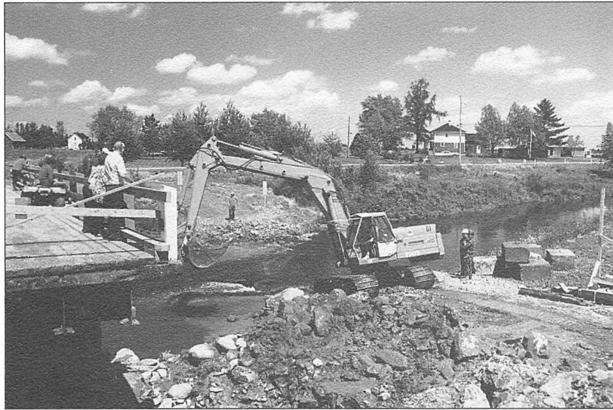
Le 27 juin 1986, après plusieurs jours de pluie, le pont temporaire, installé pendant la réfection du pont du rang Sainte-Anne, est emporté par le courant de la rivière Le Bras
