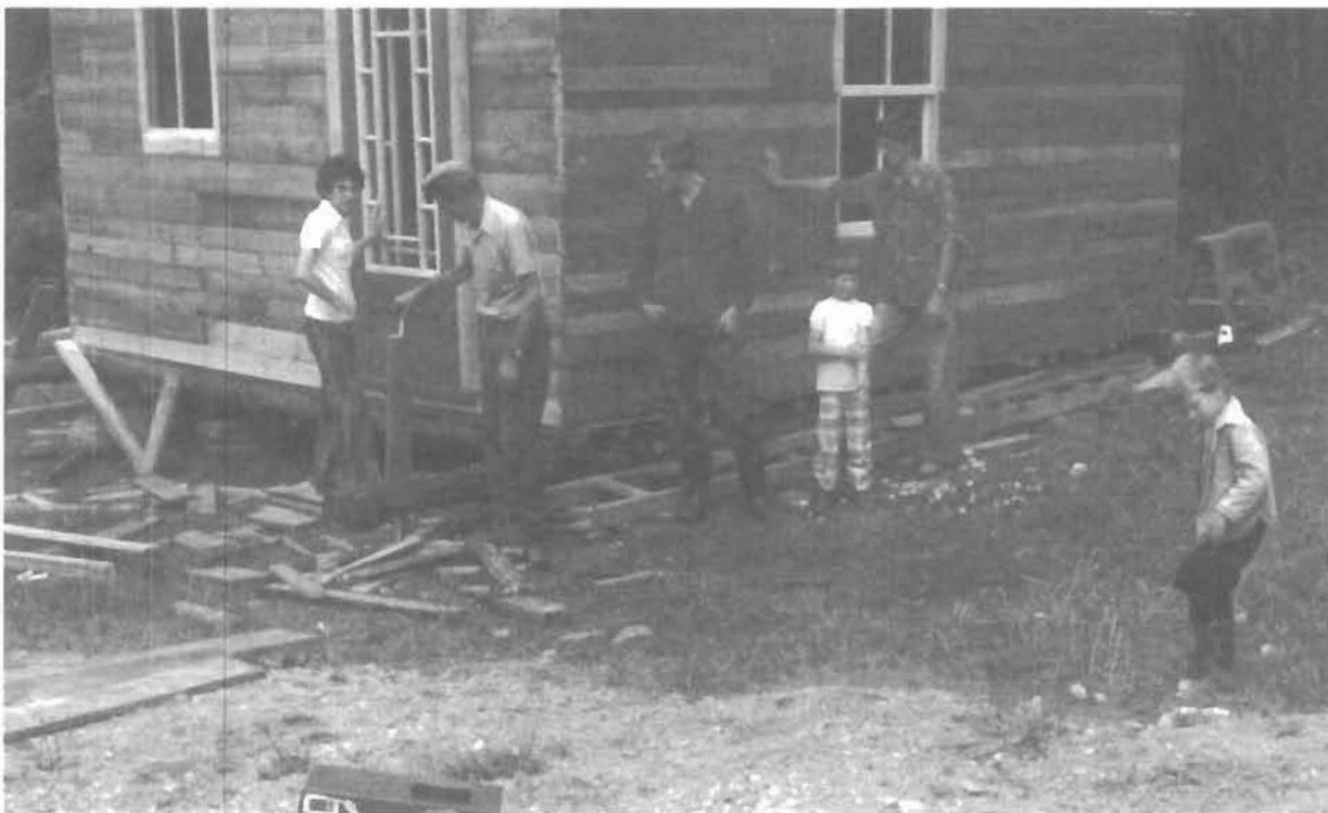
La construction du camp au 7 e rang - Émilien Lehoux, Germaine, Donald, André , Bruno et Alain en 1980
