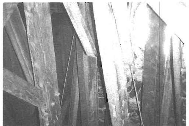
Charpente de bois (au grenier de l'église, près de l'oeil de boeuf)
