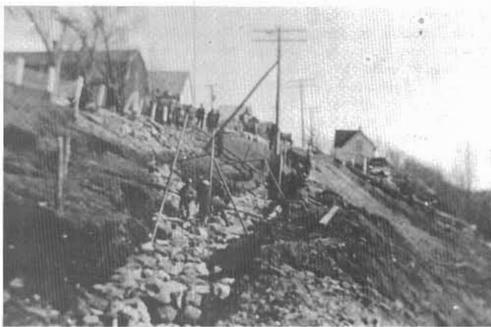
Photo prise entre 1930-1932. Réparation près du chemin Saint-Augustin. Un tremblement de terre semble avoir ouvert une brèche dans "l'écart". Des travaux sont faits pour prévenir d'éventuels éboulements.
