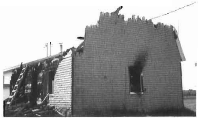
Ce qui reste de la maison après le feu, en novembre 1969
