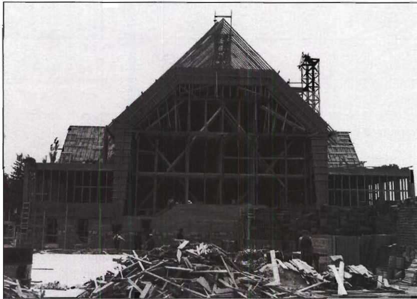
L'arrière du chantier. Le plancher de bois pour fabriquer les arches. Automne 1951.
