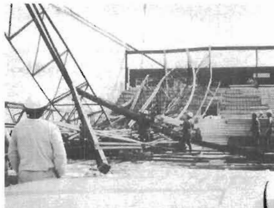
Effondrement lors de la construction de l'aréna
