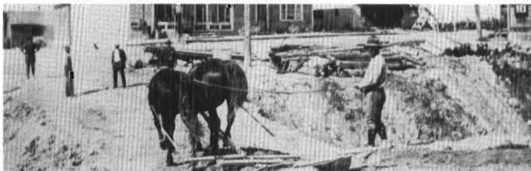
Le pont étroit menant à la station est défait. Après avoir posé un tuyau recouvert d'une forme en cèdre, les hommes remplissent avec de la terre.
