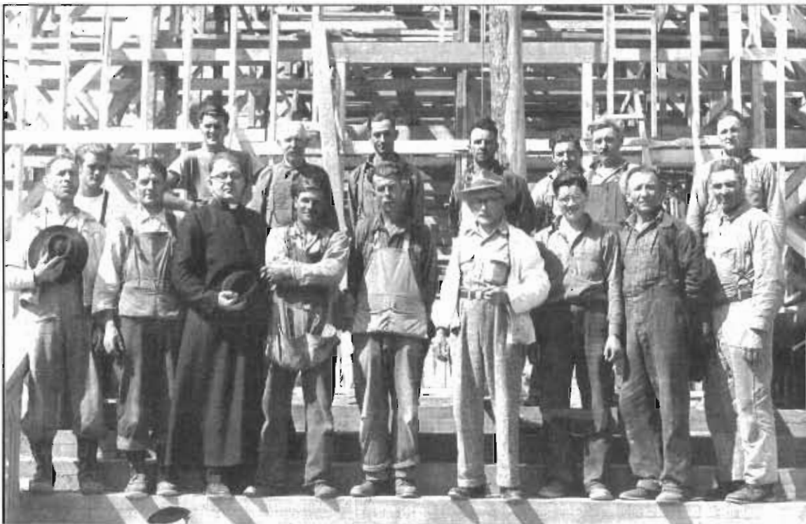
Construction de l'église de Saint-Janvier-de-Chazel, dans le cadre d'une corvée tenue à l'été 1951. 1 ère rangée : Josapha Saint-Amand, Camille Rive, l'abbé Louis-Joseph Boivert, curé, Oscar Bouchard, Paul-Émile Bordeleau, chef de chantier, M. Simard, concepteur de plans de Val-d'Or, Philippe Wait, Adélarde Noël et Eugène Turgeon. 2 e rangée : Gabriel et Jean-Guy Villeneuve, Désiré Bégin, (?), Donat Therrien, M. Veillette, Maurice Cossette et Benoît Lambert.
