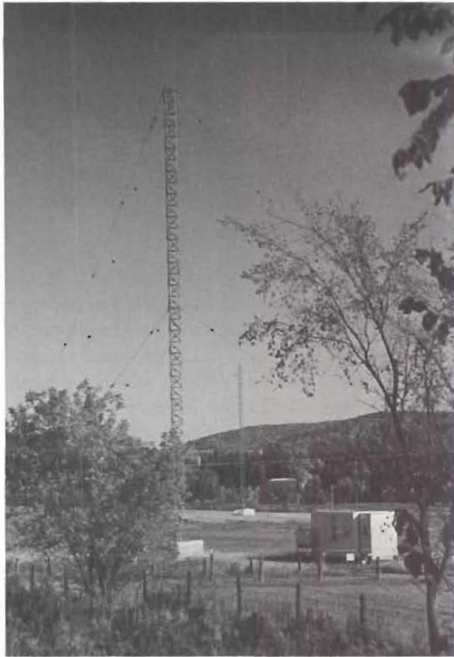
PHOTO 59 — ANTENNE DE TRANSMISSION PAR SATELLITE
