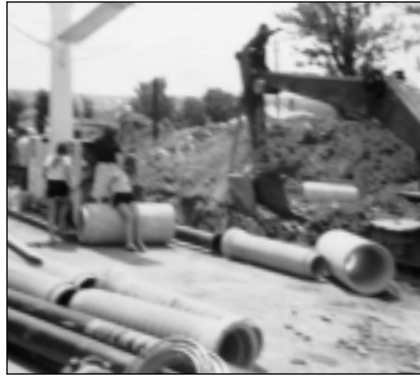
Aristide Bélanger creuse une tranchée, pour les travaux de juillet 1975, en face du restaurant Idéal. (Collection Linette Beaudoin)
