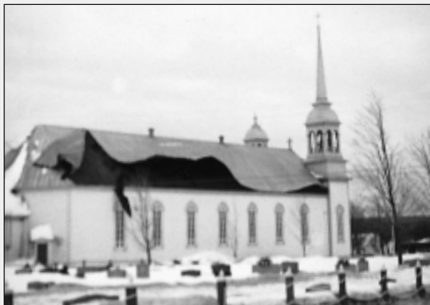
Le vent cause des dommages à la toiture, le 10 février 2001. (Photo : Jean Bouffard, février 2001)
