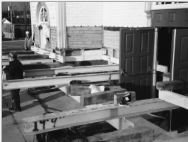
Travaux de restauration du mur de la façade, 2001. On doit soulever tout le mur avant. (Photo: André St-Pierre, novembre 2001)
