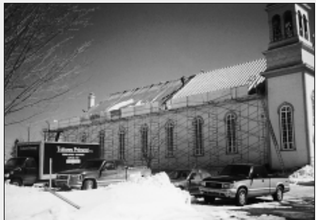
Après la tempête, il faut réparer. (Photo : André St-Pierre, mars 2001)
