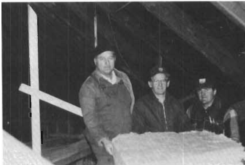
Réal Gagnon, Jacques-Aimé Bruneau, Claude Savard en train de poser la laine sur la voûte de l'église.
