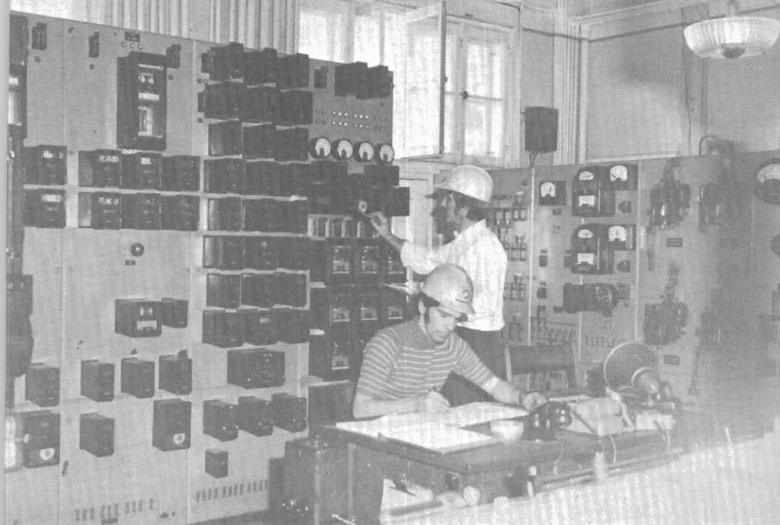
Opérateurs en fonction à la centrale des Sept-Chutes. On voit ici MM. J.-M. Dupont et Robert Chevalier.
