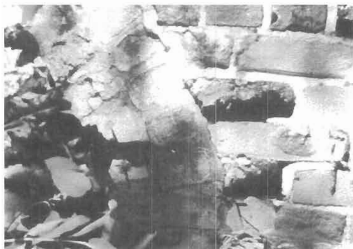
Figure 22: Partie de l'ouvrage en maçonnerie (basculée) qui démontre la présence d'un arc servant de support pour un arbre à cames. (86.D49.4)
