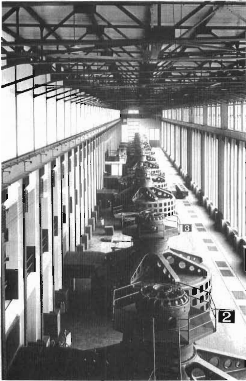
Intérieur de la centrale de l'île Maligne
