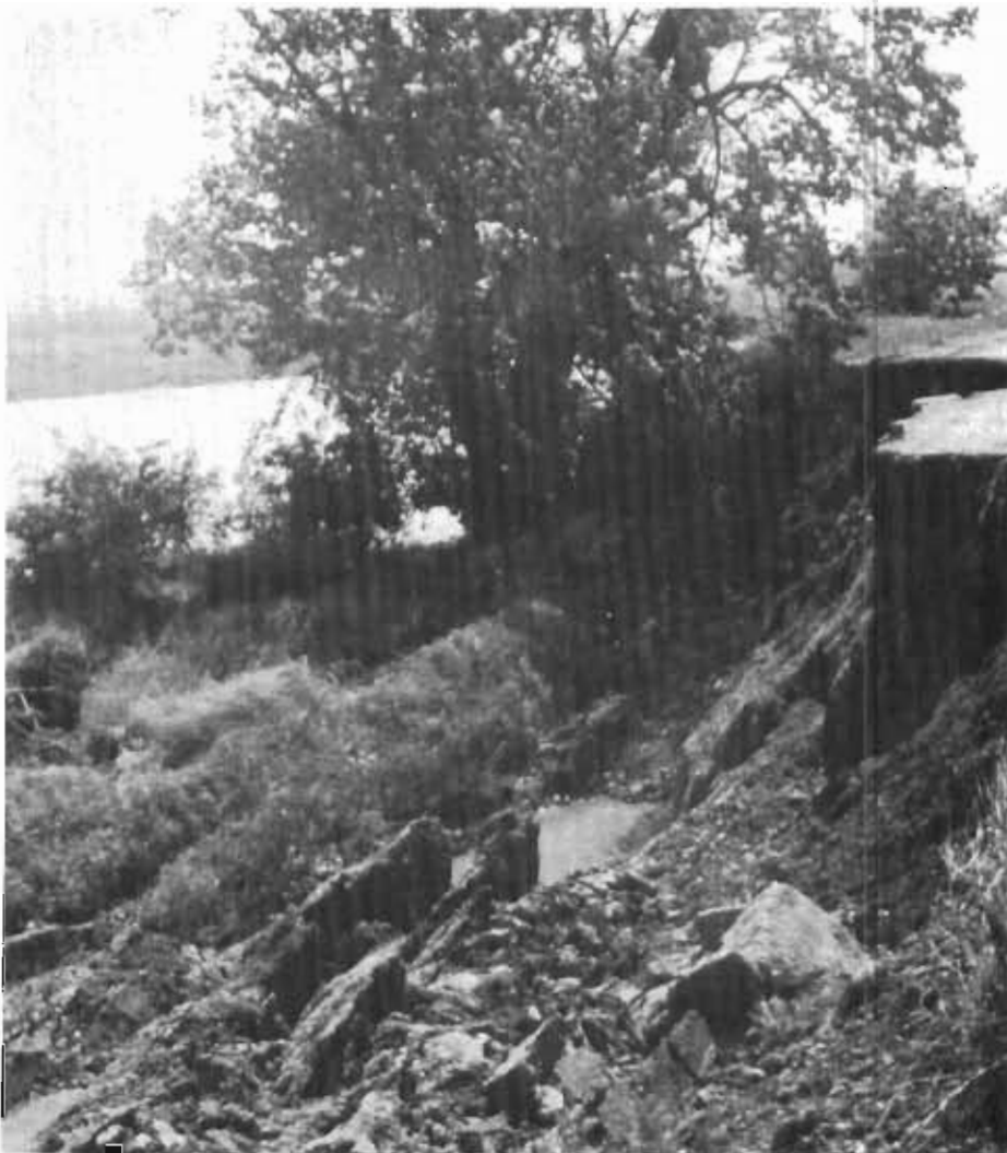
Méfais de l'érosion
