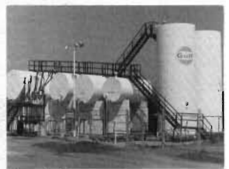
Réservoirs d'entreposage près de la voie ferrée.
