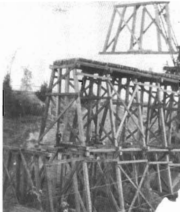
Voici l'échafaudage qui a servi à installer et fixer à demeure le pont qu'empruntent encore aujourd'hui les trains qui passent à Casselman.
