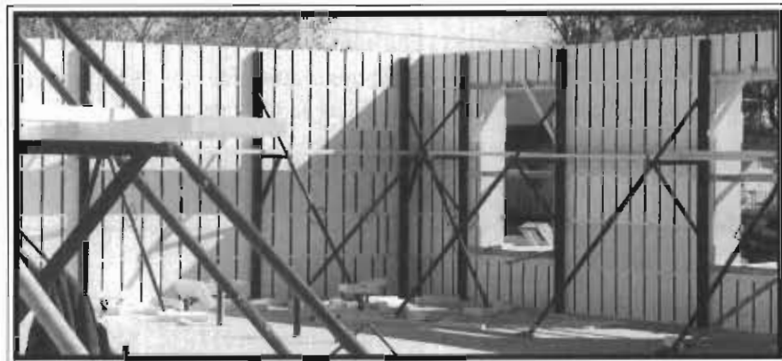
Nouvelle technologie, formes de polystyrène disponibles chez Carrière Forming.
