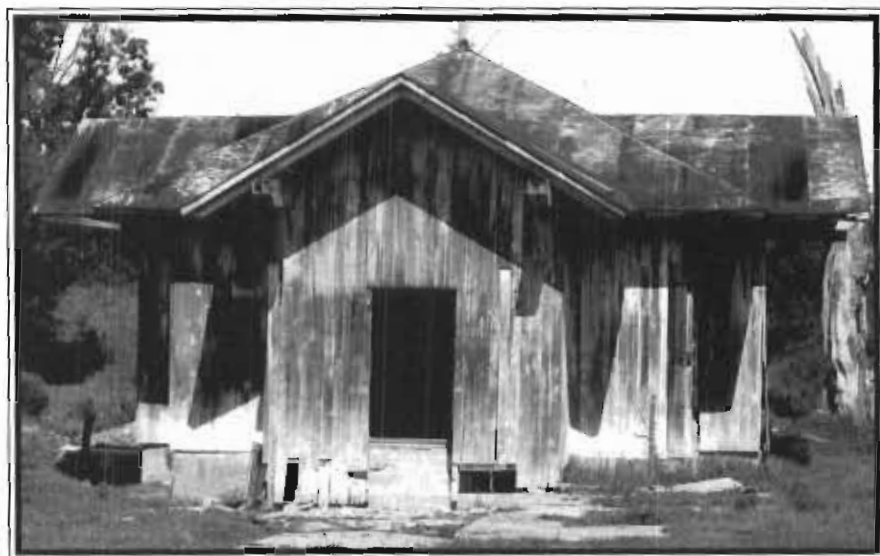
Ce pavillon de bois constitue l'un des derniers vestiges de Caledonia Springs. Source: Le Droit, 30 août 1980
