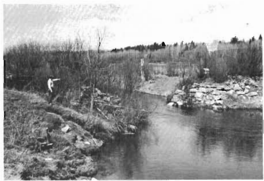
Les restes du pont qui traversait la Veuve (un peu à l'est du pont actuel) vers Hagar
