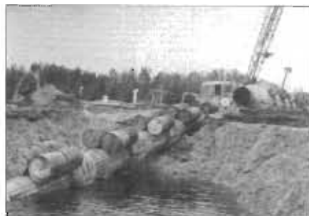
1958: The natural gas pipeline crossing the Mattagami River. The pipeline followed the CNR rail line. / Le pipeline de gaz naturel traversant la rivière Mattagami. Le pipeline longeait la voie ferrée du CN.
