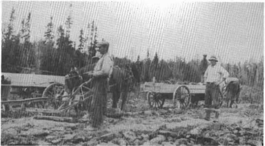
Le premier ouvrage fait pour la construction de la route 11 à Reesor entre les lots 6 et 7 durant l'été de 1929. Les travailleurs, de gauche à droite: John Janzen, John Enns (travaillant à la pelle), Franz Janzen, Jacob Ediger (faisant du labour), Gerbard Bergen (conduisant la charrue) et Elof Christianson (contremaitre).
