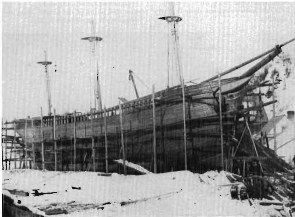
La construction d'un navire à l'anse aux Sauvages par M. Guilmour (Archives nationales du Québec, GH372-29).
