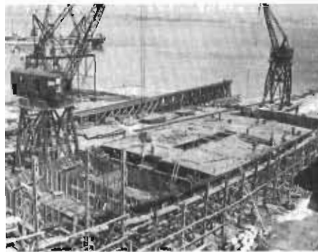
Un pétrolier de 17 846 tonnes, le "Andros Fortune", en construction, le 25 août 1954 (coll. Claude Genest).
