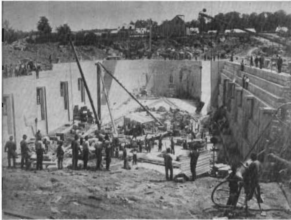
La construction de la cale sèche Lorne à Lauzon en 1880. Photo, Louis-Prudent Vallée (coll. Archives du port de Québec).
